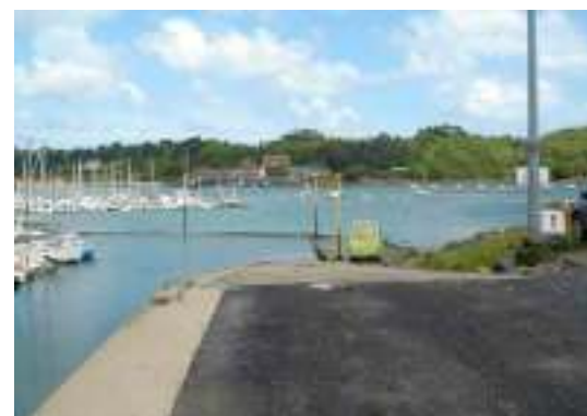
Une cale qui s'effondre
